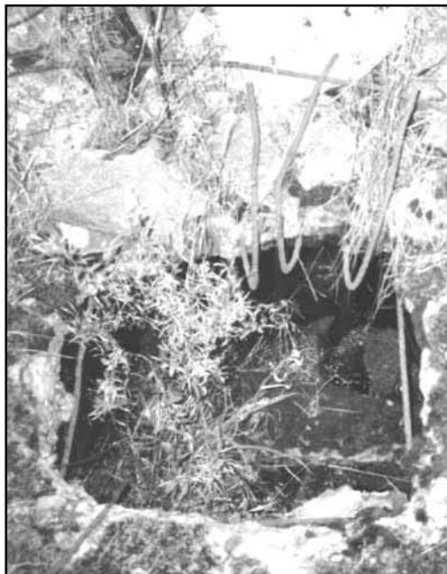
Obr. 58: Údajný otvor na vha-zování cyklonu B ve střeše márnice I („plynové komory“) krematoria II. Je jasné vidět, že nebyl zbaven ocelových výztuží. Ty byly jednoduše ohnuty.
